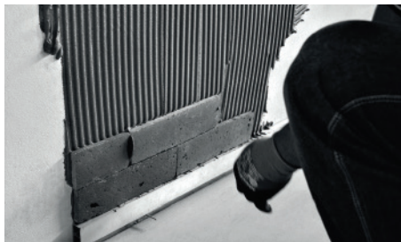
Foto 18: Excesso de argamassa na lateral da placa
