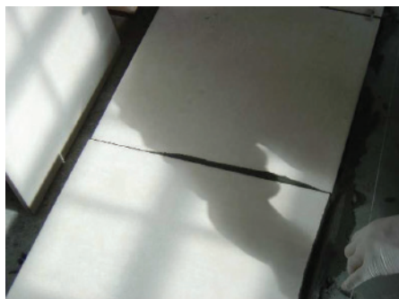
Foto 21: Excesso de argamassa colante sobre as peças
