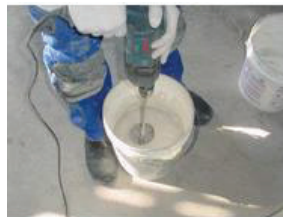
Foto 32: Preparo do rejunte com a utilização de haste helicoidal acoplada a furadeira
