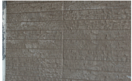
Foto 34: Juntas preenchidas com rejunte e excesso na superfície das placas
