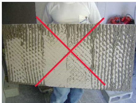
Foto 27: tardoz da placa com falha de preenchimento de argamassa colante - INCORRETO
