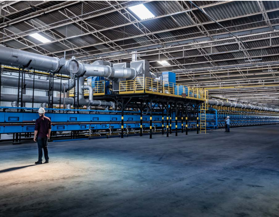
El horno de la fábrica Lastras en la unidad fabril de Tijuca (SC). Se trata de una de las emisiones de gases de efecto invernadero que medimos
